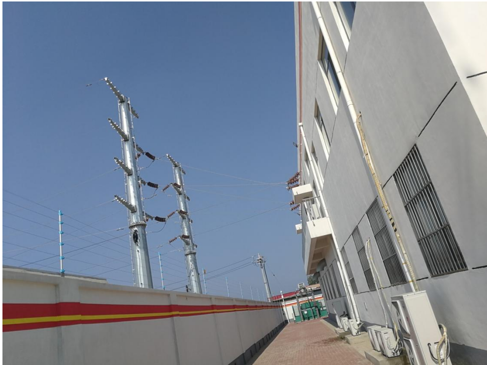
2 回 35kV 架空进线
